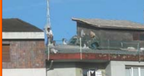
Trabajadores de empresa no inscrita en el RERA, realizando trabajos de retirada de MCA sin hacer uso de medidas preventivas
