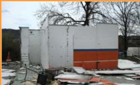
Restos de acto de vandalismo en edificio con tabiques de fibrocemento
