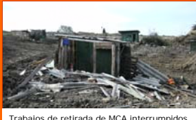
Trabajos de retirada de MCA interrumpidos. Material no friable en mal estado. Falta de acotamiento y señalización
