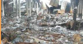
Restos de incendio de pabellón industrial con cubierta de fibrocemento. Material no friable en mal estado
